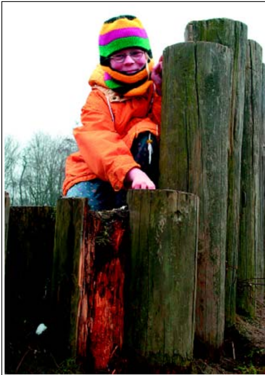
Linda zeigt dem Fotografen den schlechten Zustand der Holzpalisaden am „Abi“
